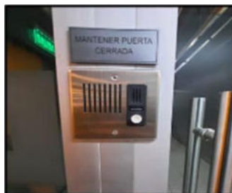
CITOFONO HALL SUBTERRANEOS
