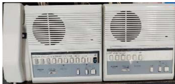
CENTRAL DE CITOFONÍA RECEPCIÓN
