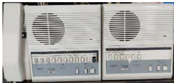
CENTRAL DE CITOFONÍA RECEPCIÓN
