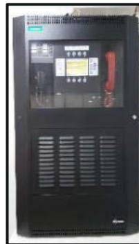
CENTRAL DE INCENDIO
