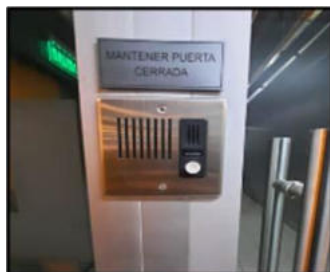
CITOFONO HALL SUBTERRANEOS
