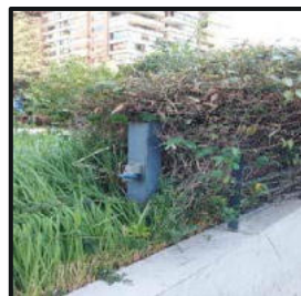
RED INERTE TOMA EXTERIOR
